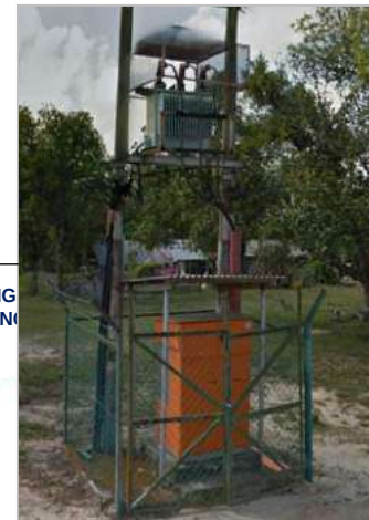
Pencawang Elektrik Jalan Sg. Redan
