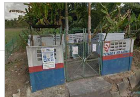
Pencawang Elektrik Jalan Sg. Redan
