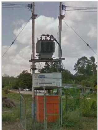
Pencawang Elektrik Kg. Sg. Tiram
